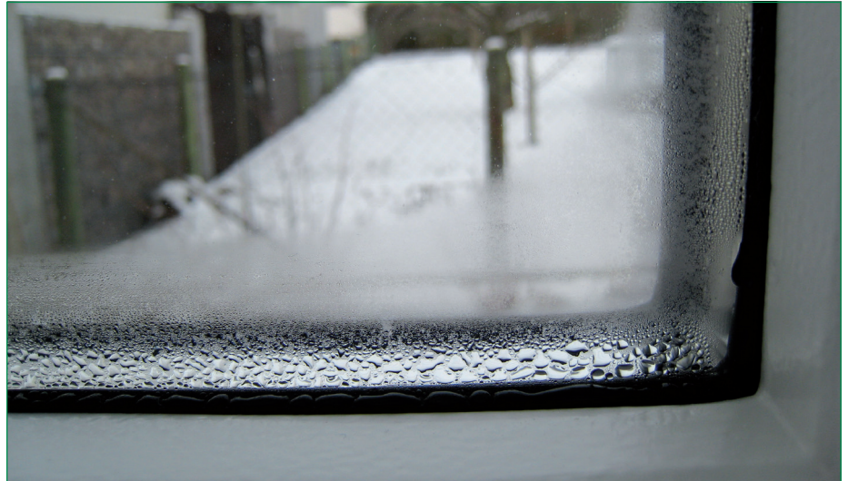
Abb. 3: Durch den Aluminium-Abstandhalter im Isolierglas kann am Rand der Glasscheibe leicht Tauwasser entstehen.
