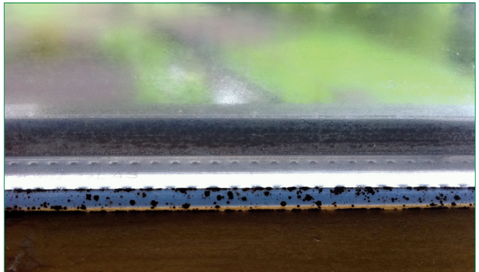
Abb. 4: Längerfristig droht dadurch Schimmelbildung, was nicht nur aus hygienischen Gründen inakzeptabel ist.
